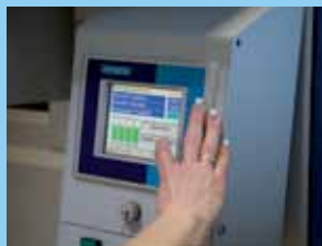
Centre de contrôle du Jenrail 2000 Automatic avec automate programmable Jentrol HMI et système de contrôle avec écran tactile.
